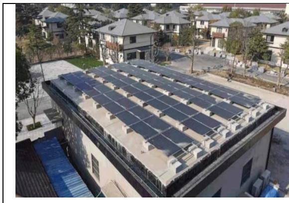
图 10.1-1 智慧小镇光伏实例
